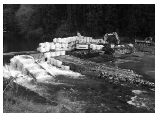
被災時の、川上川の釜藤堰
